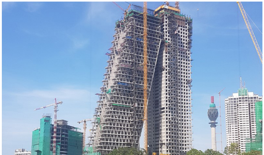
உரு 150: கொழும்பு கங்காராமையில் (gangaramaya) அமைந்துள்ள அல்ரெயா கட்டிடம் (altair building), (கலப்பு அபிவிருத்தி), நிர்மாணிக்கப்படுகின்றது | பட உதவி : skyscraper.com
